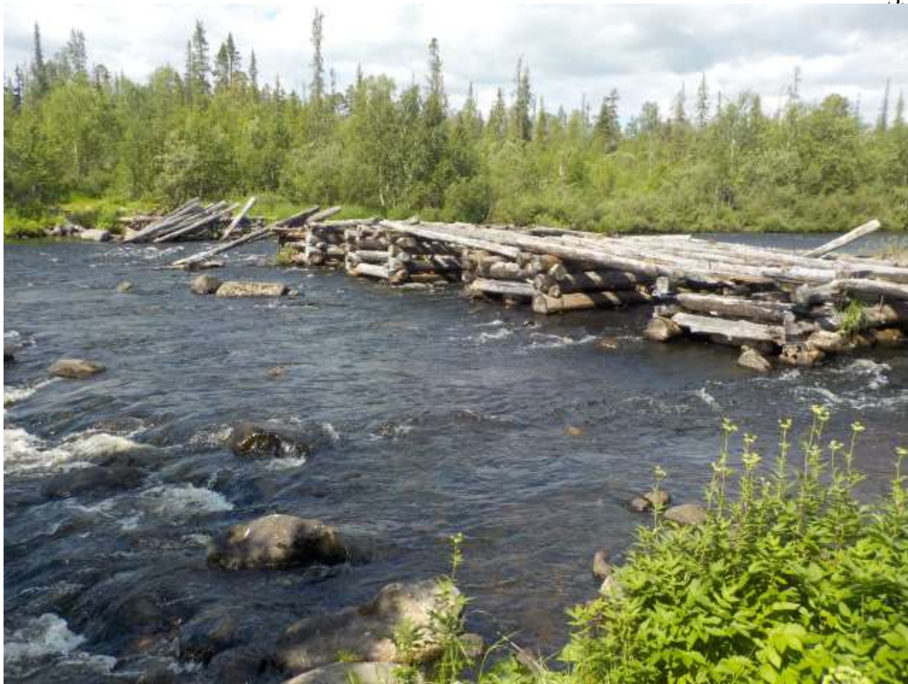
Ф. 6-2. Разрушенный мост через р.Сура
